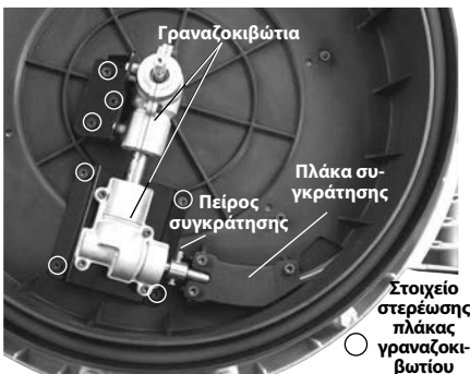
Εικόνα 11 – Ανοιγμένο περίβλημα μηχανήματος απόφραξης αποχετεύσεων
